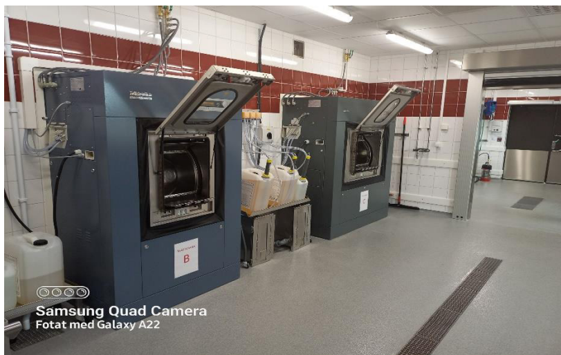
Barrieremaskiner for dekontaminering av pustemasker og innsatsklær med Lejon Kemis vaskemidler og optimaliserte vaskeprogrammer.
